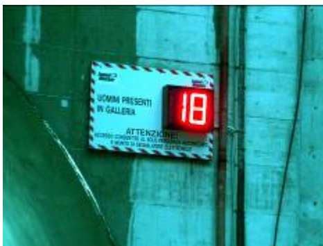
Display esterno rilevazione presenze in galleria
