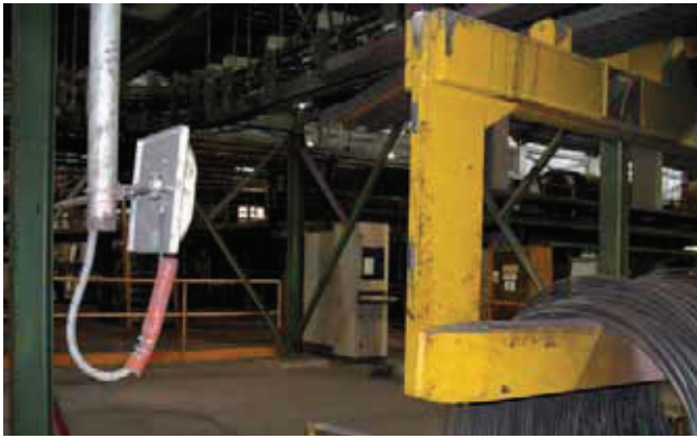
La sfida maggiore che la tecnologia Rfid ha dovuto affrontare ha riguardato il difficile ambiente operativo del laminatoio
